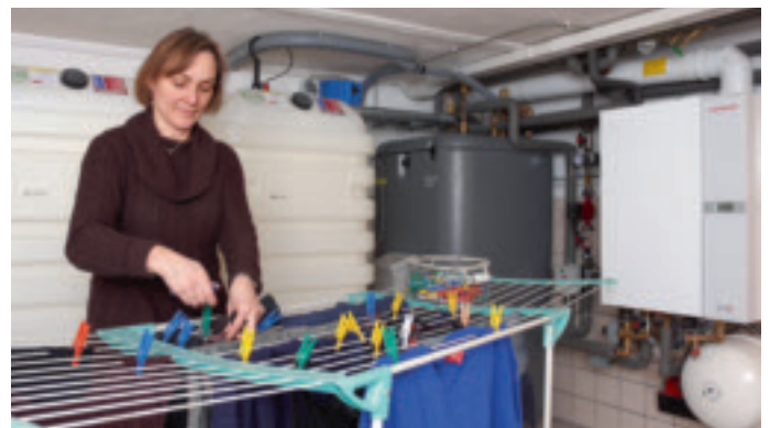
Der raumluftunabhängige Betrieb erlaubt Helen Kreins, den Aufstellraum der Heizung auch weiterhin zum Wäschetrocknen zu nutzen.
