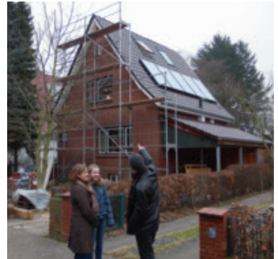
Die Zwölf-Quadratmeter-Solaranlage dient zur Warmwasserbereitung und Heizungsunterstützung.
