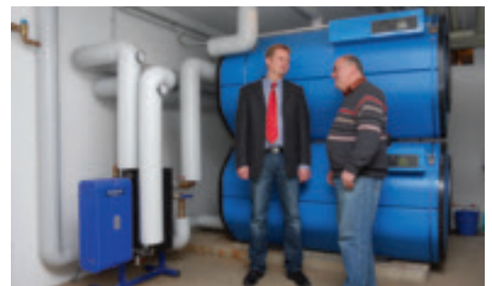
Zentrale Warmwasserbereitung für 117 Wohnungen
