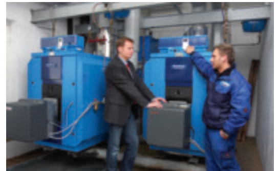
Effiziente Ölheiztechnik spart 25 Prozent Energie.
