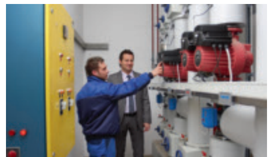
Leistungsgeregelte Umwälzpumpen sparen Strom.
