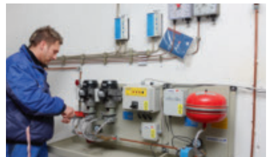
Sichere Versorgung durch zwei Förderaggregate
