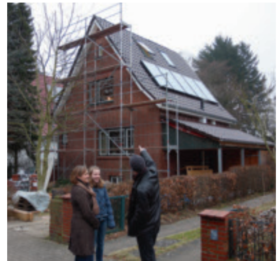
Die Zwölf-Quadratmeter-Solaranlage dient zur Warmwasserbereitung und Heizungsunterstützung.
