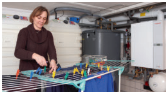
Der raumluftunabhängige Betrieb erlaubt Helen Kreins, den Aufstellraum der Heizung auch weiterhin zum Wäschetrocknen zu nutzen.
